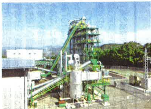
グリーン発電大分・天瀬発電所
