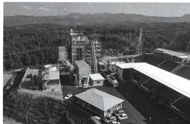
天瀬発電所 発電施設
